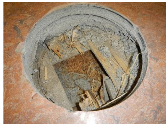
Rakenneavaus VP3: Välipohjan muottipuussa on viite mikrobivauriosta.
