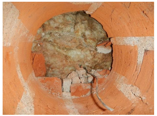
Rakenneavaus US7: Ulkoseinän kivivillassa on vahva viite vauriosta (Näyte 11).
