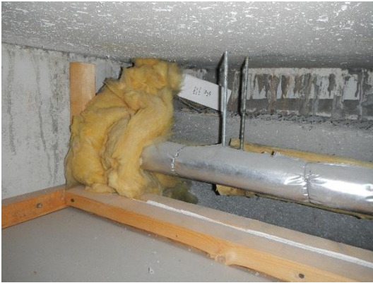
Rakenneavaus VP2: Näkymä kotelolaatan kotelotilaan. Läpivientien kohdilla putkieristyksissä on käytetty runsaasti mineraalivillaa.
