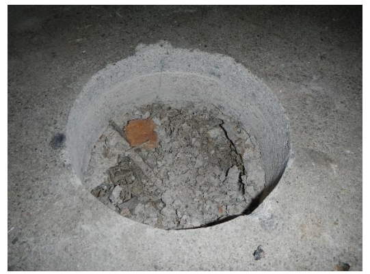
Rakennevaas AP3: Alapohjan tojalevyssä on vahva viite vauriosta (Näyte 8).
