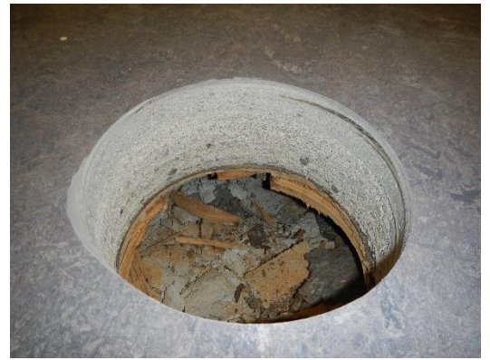
Rakenneavaus VP4: Välipohjan eristämateriaalissa (kutterinpuru) on vahva viite mikrobivauriosta.
