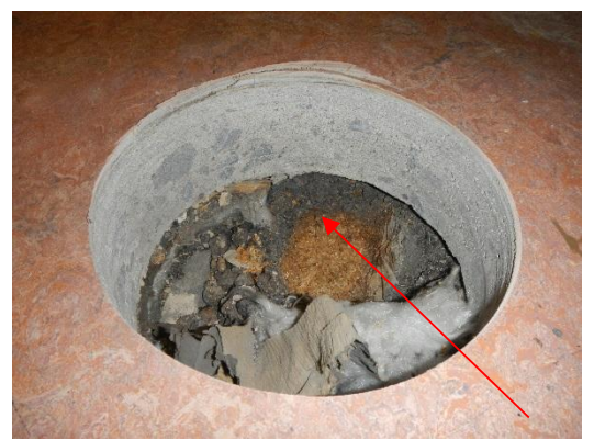
Rakenneavaus VP6: Välipohjan eristämateriaalissa (kutterinpuru) on vahva viite mikrobivauriosta.
