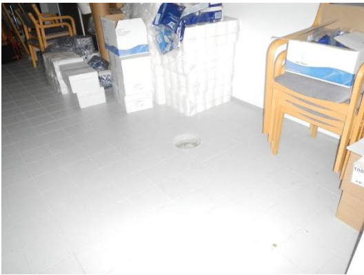
Rakennevaas AP4: Sijainti varastossa 006.
