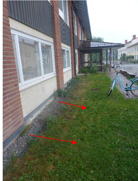
Rak-kuva 2 Rakennuksen etelä- ja länsisivun sokkelin vierustojen kaatoja tulee parantaa
