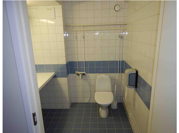
Lvi-kuva 4 Yleiskuva vesi- ja viemärikalusteista
