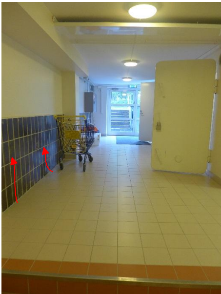
Rak-kuva 3 Alapohjalaatan alla oleva kosteus nousee kapillaarisesti kantavien väliseinien ja pilareiden kautta
