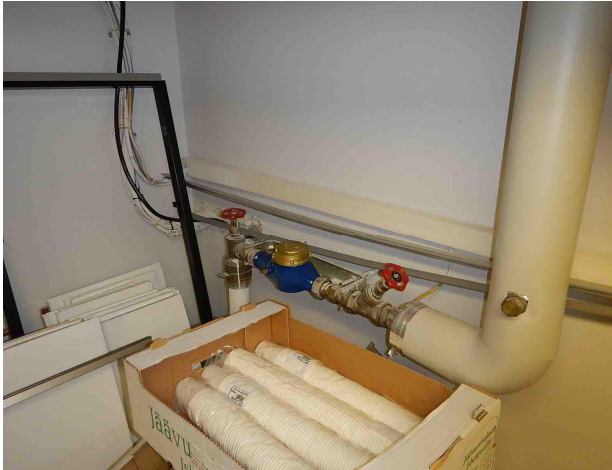
Lvi-kuva 3 Yleiskuva vesimittarista
