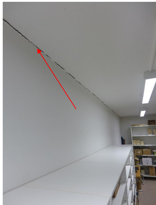
Rak-kuva 8 Tilassa 125 on aiheutunut vaurioita uuden välipohjalaatan painumisen takia.
