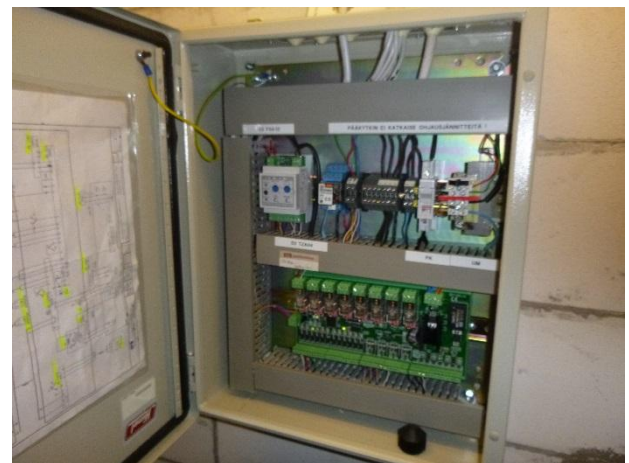
S-kuva 8 Rakennusautomaatiojärjestelmän alakeskus.
