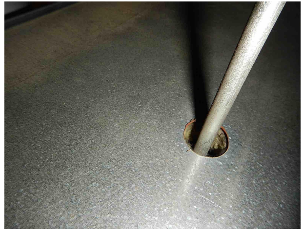
Lvi-kuva 8 Läpivienneissä on suojaamattomia mineraalivillakuituja
