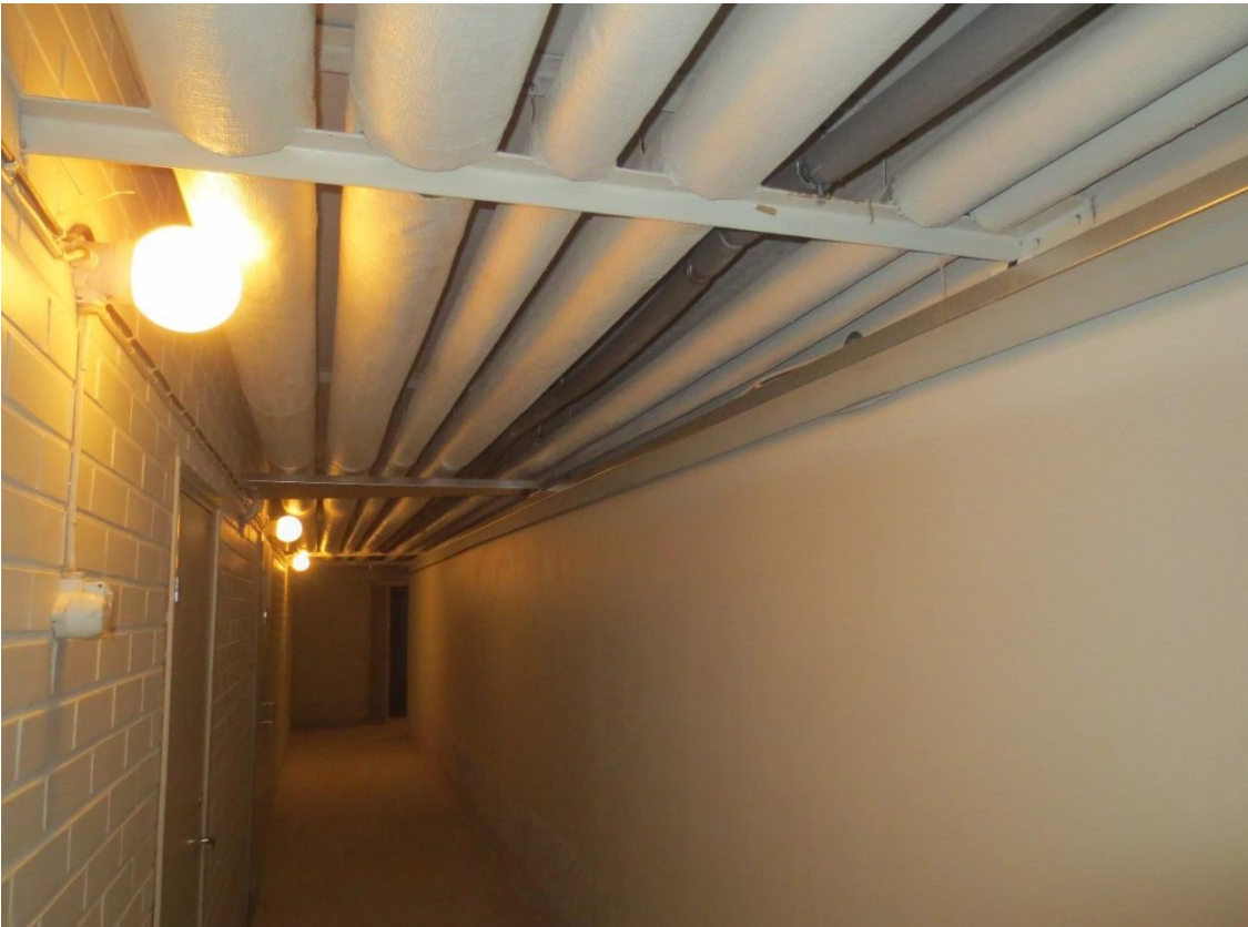
Kuva 5. Kellarin käytävällä olevat putkien pinta on asbestipitoinen. Putkien mutkat ovat asbestimassaa.
