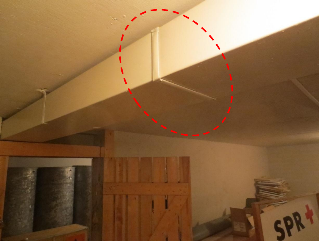
Kuva 9. Kellarissa kanttikanavan liitoskohdan tiivisteessä on asbestia .
