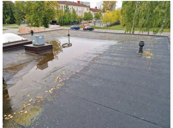
Kuva 94 Rippikoulusiiven keittiötilojen vesikatolle oli lammikoitunut runsaasti vettä.
