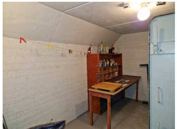
Kuva 20 Väestönsuojan kohdalla oleva maanvastainen seinärakenne (tila 0.22). Väestönsuojan maanvastaisissa seinissä ei todettu selvästi poikkeavaa kosteutta pintakosteudenilmaisimella.
