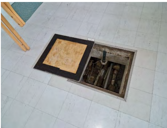
Kuva 42 Rippikoulusalin 1.11 alapohjassa on epätiivis putkikanaalin luukku.
