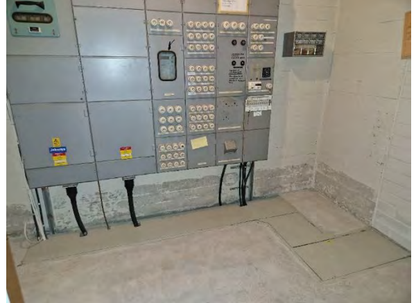
Kuva 14 Kellarikerroksen maanvastaisten seinien alaosista on poistettu maali- ja rappauspinnat rakenteissa esiintyvän poikkeavan kosteuden takia (tila 0.06).
