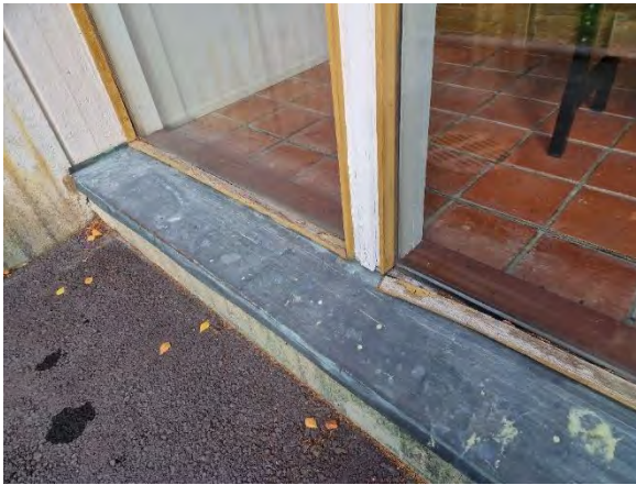
Kuva 64 Ikkunarakenteista irtoaa paikoin puulistoja. Ikkunapellitysten kaadot ovat monin paikoin puutteellisia.
