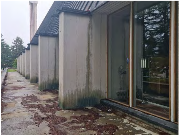
Kuva 58 Kirkkosalin idän puoleisella julkisivulla vesikatolta julkisivujen pintaan valuva vesi aiheuttaa betonipintojen piste- mäistä kosteusrasitusta ja värjäytymistä.
