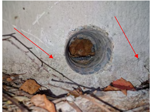
Kuva 63 Sakaristosiiven sisäpihan puoleisen seinän alaosassa esiintyy ulkopuolisen kosteusrasituksen aiheuttamia vauriojälkiä.
