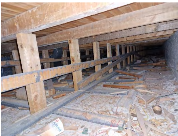
Kuva 84 Lehterin korokelattian alla on rakennusjätteitä.
