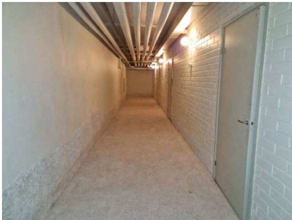
Kuva 88 Kellarikerroksessa väliseinärakenteiden alaosissa esiintyy monin paikoin poikkeavaa kosteutta. Seinien alaosista on poistettu maali- ja rappauspinnat.
