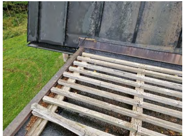
Kuva 110 Kuva Sakaristosiiven hiljaisen huoneen 1.20 seinien yläosassa olevien kosteusvauriojälkien yläpuolelta.
