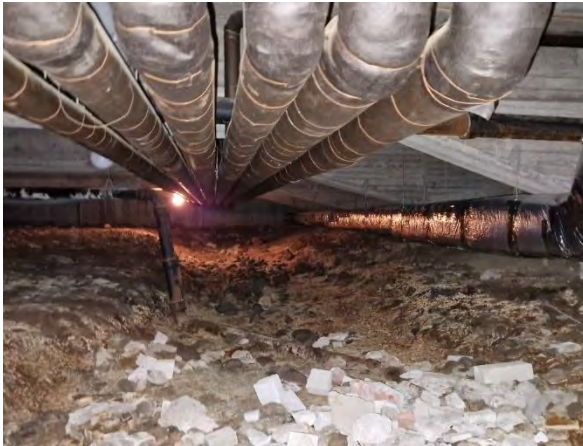
Kuva 38 Ryömintätilassa täyttömaana on märkä hieno hiekka. Märkä hiekka tarttuu kenkiin kiinni ryömintätilassa liikuttaessa.
