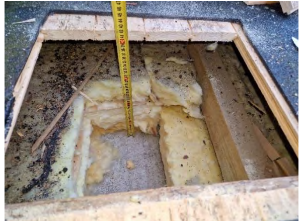
Kuva 98 Rakenneavauspisteessä YP1 yläpohjan lämmöneristeissä ei havaittu ilma- tai vesikattovuotojen aiheuttamia vaurioita.
