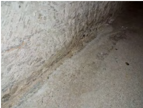
Kuva 17 Sakaristosiiven kellarikerroksen käyvällä 0.31 ja varastotilassa 0.27 maanvastaisessa seinässä kosteusvauriojälkiä (kalkkihärmää), mikä kertoo merkittävästä rakenteeseen kohdistuvasta kosteusrasituksesta.
