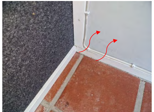
Kuva 50 Ilmavuotoja tapahtui paikallisesti myös ulkoseinän ja alapohjarakenteen liittymästä. Ilmavuotokohta voi jatkua alttari-korokkeen alle.
