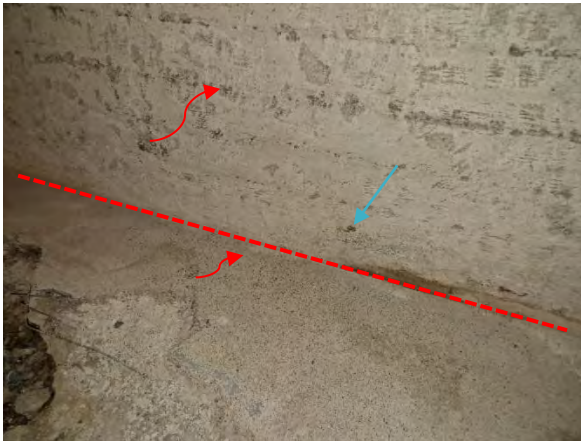
Kuva 27 Merkkiaineen syöttöpiste esitetty kuvassa sinisellä nuolella. Maanvastaisen seinän eristetilasta tapahtui ilmapuotoja alapohjan ja maanvastaisen seinän liittymästä, vanhojen patterikiinnikkeiden kohdista ja alapohjan betonilaatassa olevasta halkeamasta.
