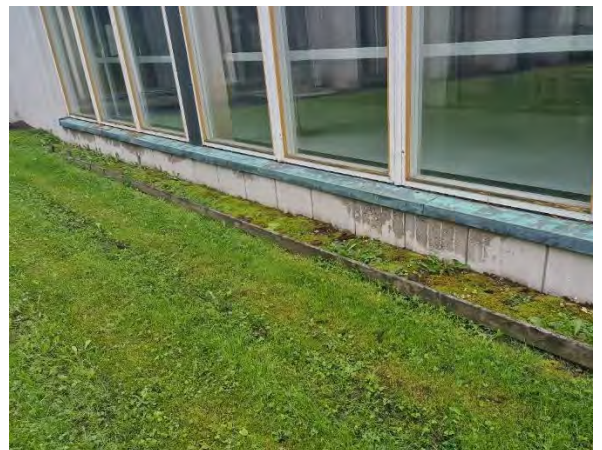
Kuva 61 Rippikoulusiiven sisäpihalla ulkoseinien alaosissa esiintyy kosteusvauriojälkiä.
