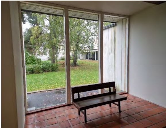
Kuva 51 Merkkiainetta johdettiin ryömintätilan sisäilmaan myös sisäpihan puoleisen maanvastaisen seinän ja väestönsuojaa vasten olevan väliseinän läheisyyteen.
