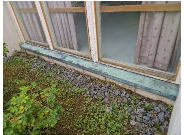
Kuva 65 Ikkunat ja ikkunapellitykset ovat yleisesti huonokuntoisia. Ikkunapellitysten kaadot ovat monin paikoin puutteellisia.
