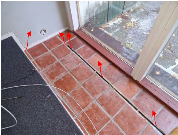
Kuva 49 Ryömintätilasta tapahtui merkittäviä ilmavuotoja tuloilman päätelaitteiden läpivientien kautta sekä paikallisesti ulkoseinän ja alapohjarakenteen liittymästä.
