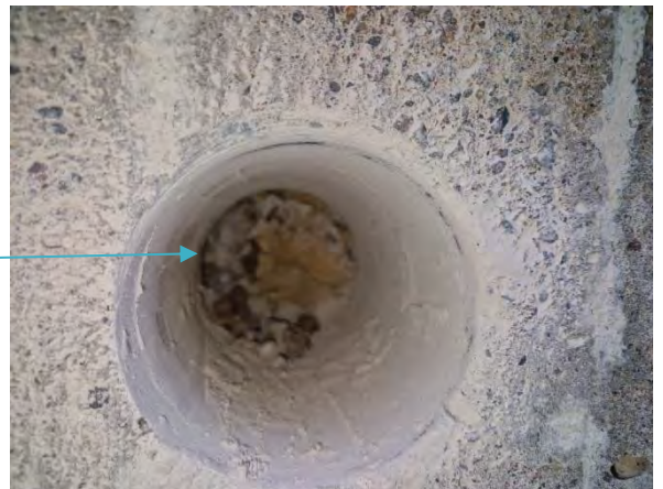
Kuva 67 Rippikoulusiivessä ulkoseinän alaosan /sokkelin lämmöneriset on yhteydessä alapohjan lecasora-eristekerrokseen.
