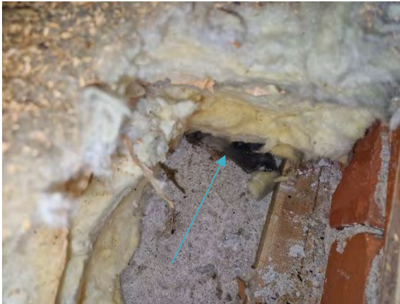
Kuva 107 Sakaristosiiven yläpohjassa olevien lämmöneristeiden alapinnassa esiintyy mahdollisia ilmavuotojen aiheuttamia tummentumia. Kuvan oikeassa reunassa tiilirakenteinen vaakasuuntainen kanaali.
