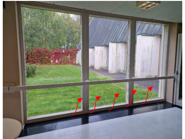
Kuva 73 Selviä ilmapuotoja tapahtui ikkunan ja alapohjan liittymistä. Ko. liittymässä oli havaittavissa mikrobiperäistä hajua.
