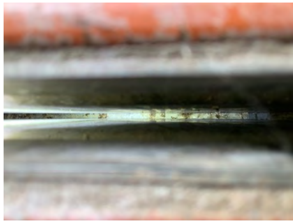
Kuva 14 Pääte-elimien sisällä on epäpuhtauksia.
