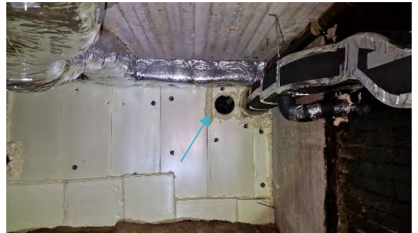
Kuva 45 Ryömintätilassa (varaston 0.08 puoleisessa kulmassa) oleva korvausilmaventtiili.
