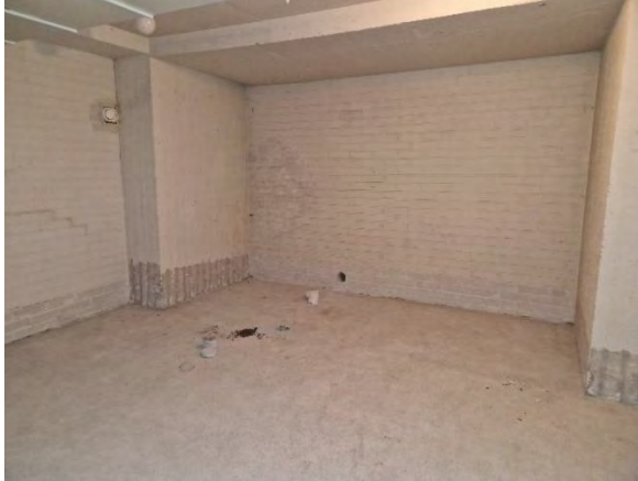
Kuva 13 Kirkkosalin alapuolella olevan kellarikerroksen maanvastaisten seinien alaosista on poistettu maali- ja rappauspinnat rakenteissa esiintyvän poikkeavan kosteuden takia (kuva tilasta 0.08).
