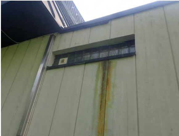
Kuva 111 Sakaristosiiven hiljaisen tilan 1.20 vauriokohta ulkopuolelta kuvattuna. Sadevesikouru johtaa sadevesiä julkisivun pintaan.
