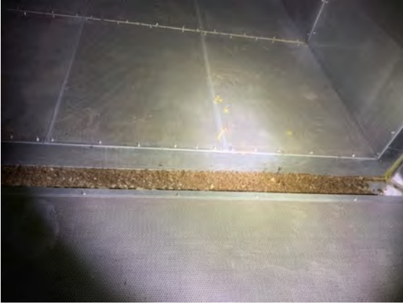
Kuva 5 Kiertoilmakammion pohjalla on erittäin runsaasti epäpuhtauksia.
