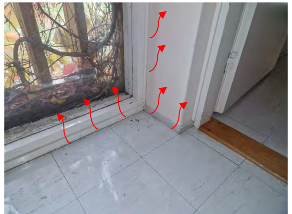
Kuva 75 Sakariston 1.23 ulkoseinässä todetut ilmapuotoreiitit osoitettu punaisilla nuolilla.
