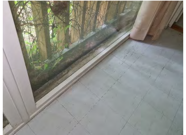
Kuva 77 Kuva Sakaristosiiven ikkunarakenteen kosteusvaurioista.
