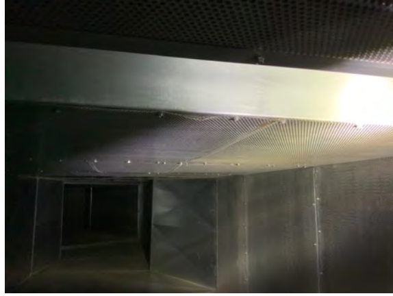
Kuva 6 Reikäpellin ja mineraalivillan välinen muovikalvo on epätiivis paikoin ja tämä voi mahdollistaa mineraalivillan pääsyn tuloilmaan.
