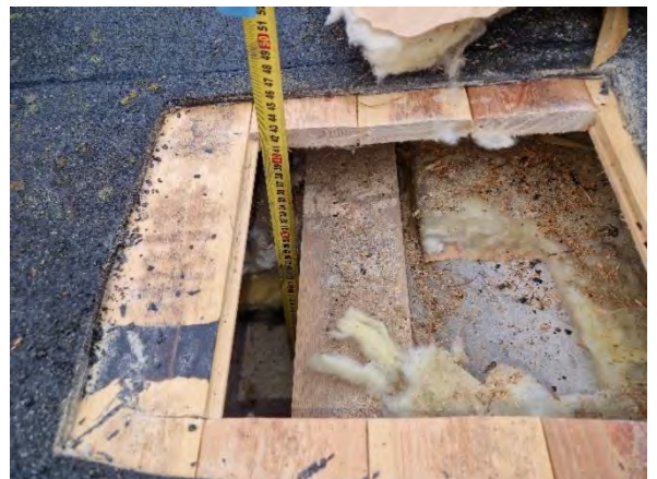
Kuva 106 Sakaristosiiven yläpohjan avaus osui osittain yläpohjassa kulkevan tiili/betonirakenteisen vaakakanaalin kohdalle. Kanaalin päällä oli vain ohut mineraalivillaeristekerros.
