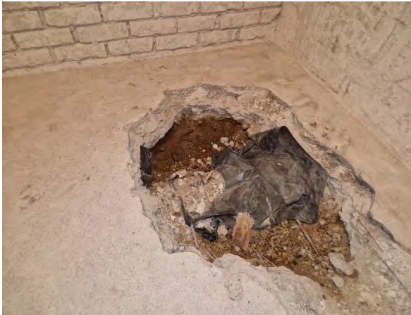
Kuva 32 Varaston 0.27 kohdalla alapohjassa on aukko. Aukon kohdalla on muovilla peitetyt rikkoutuneet tiilisalaojaputket.
