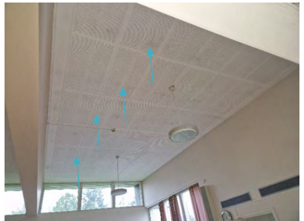
Kuva 104 Rippikoulusalin 1.11 kevytbetonisen yläpohjan alapinnassa esiintyy ilmavuo- tojen aiheuttamia tummentumia
