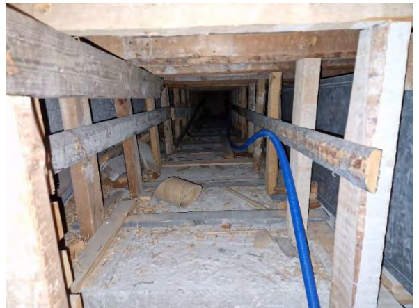
Kuva 83 Lehterin korokelattian alla on rakennusjätteitä.
