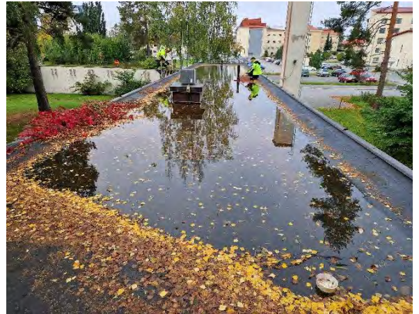
Kuva 96 Sakaristosiiven vesikatolle oli lammikoinnut paljon vettä.
