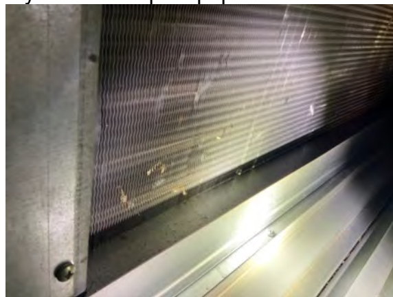
Kuva 4 Lämpöpatterissa on hieman epäpuhtauksia.
