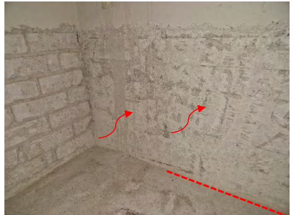
Kuva 28 Maanvastaisen seinän eristetilasta tapahtui ilmapuotoja väliseinän ja maanvastaisen seinän rakenneliittymästä ja vanhojen patterikiinnikkeiden kohdista.
