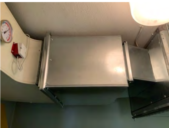
Kuva 9 Koneen jälkeisessä äänieristetyssä kammiossa ei ole tarkastusluukkuja.
