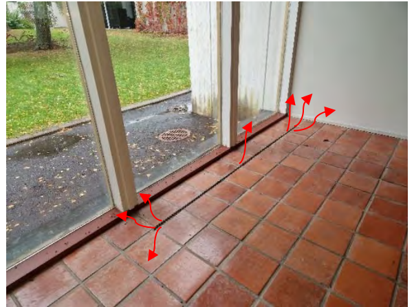
Kuva 52 Ryömintätilasta tapahtui merkittäviä ilmavuotoja tuloilman päätelaitteiden läpivientien kautta.
