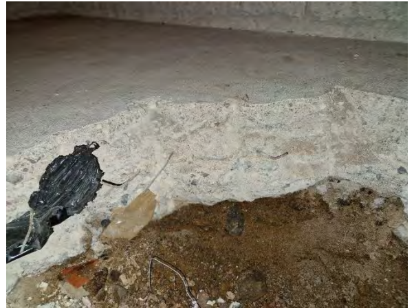
Kuva 33 Sakaristosiiiven kellarin alapohjissa ei ole kosteus- tai lämmöneristeitä. Alapohjissa esiintyy poikkeavaa kosteutta.
