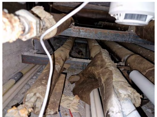
Kuva 43 Kanaalissa on mineraalivillalla eristettyjä lämmitysputkia, rakennusjätteitä ja muita epäpuhtauksia.
