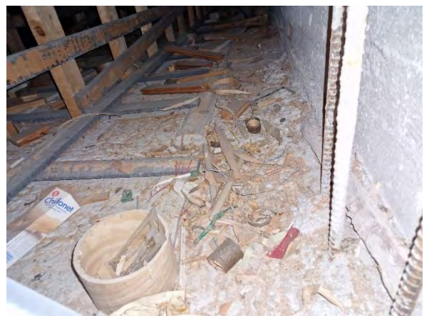
Kuva 85 Lehterin korokelattian alla on rakennusjätteitä.
