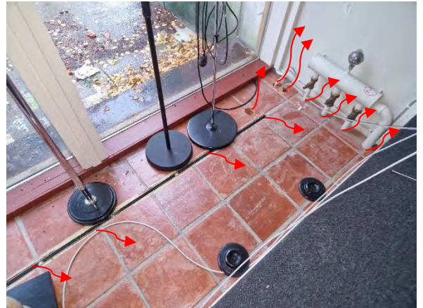
Kuva 48 Ryömintätilasta tapahtui merkittäviä ilmavuotoja sähköläpivientien, lattialämmitysputkien läpivientien ja tuloilman päätelaitteiden läpivientien kautta.
