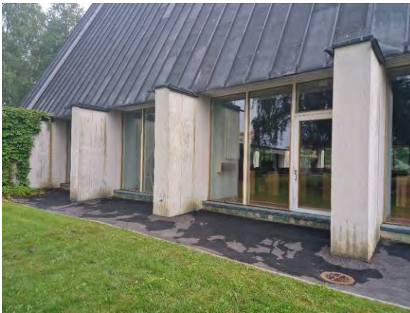
Kuva 113 Kirkkosalin kuparikatteelta sadevedet ohjautuvat suoraan maahan tai sadevesikouruihin, jotka johtavat sadevesiä julkisivujen pintaan.
