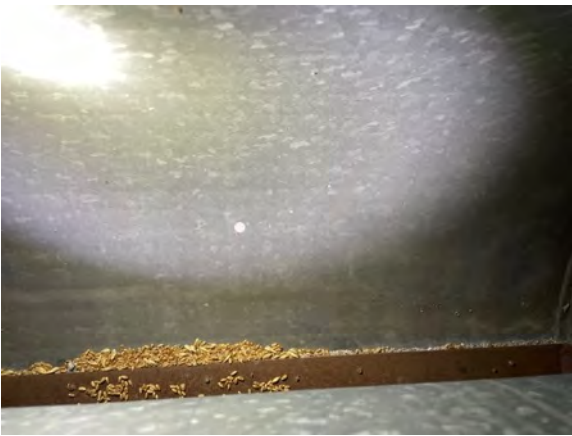
Kuva 13 Pääte-elimien sisällä on epäpuhtauksia.
