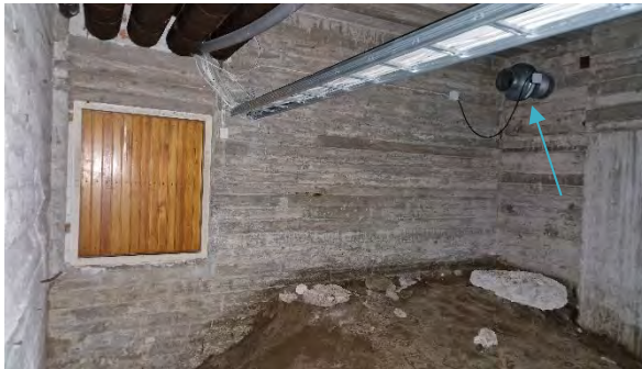
Kuva 44 Ryömintätilassa Sakaristosiiven puoleisessa kulmassa oleva kanavapuhallin.
