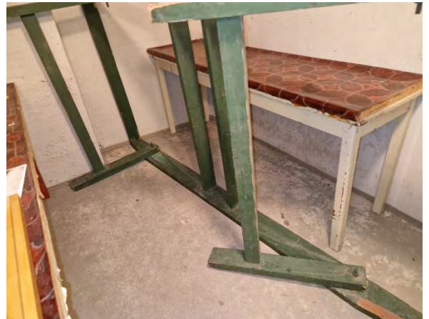
Kuva 35 Väestönsuojan lattiapinnoitteet ovat paikoin kuluneet.
