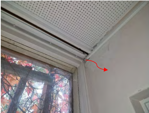
Kuva 76 Sakariston 1.23 ulkoseinässä todettiin selvä ilmavuotokohta myös ikkunarakenteen yläosassa.
