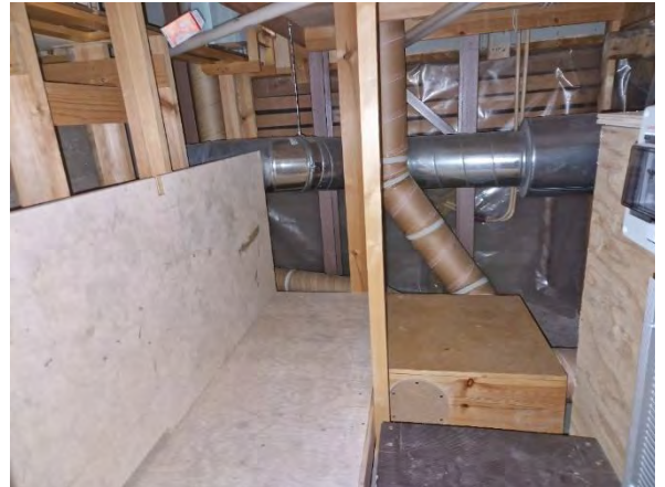
Kuva 81 Kuva luukun kohdalla olevasta tilasta. Tilaan on asennettu uudempaaakin talotekniikkaa.
