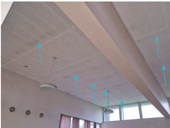
Kuva 103 Rippikoulusalin 1. 11 kevytbetonisen yläpohjan alapinnassa esiintyy ilmavuo- tojen aiheuttamia tummentumia
