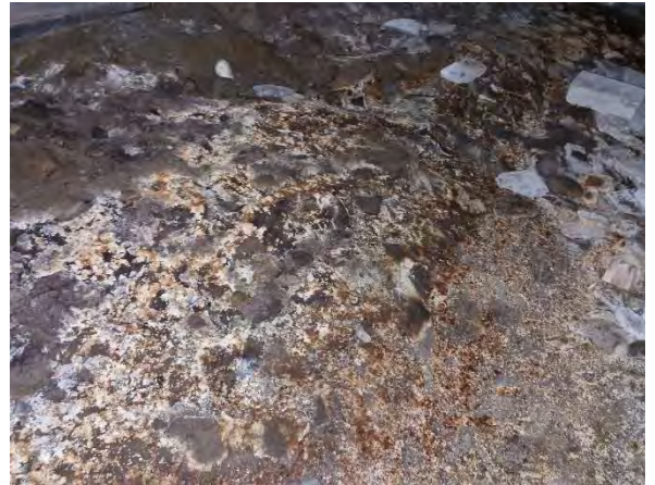
Kuva 39 Ryömintätilassa täyttömaan päällä esiintyy runsaasti poikkeavan kosteuden aiheuttamaa kalkkihärmää.
