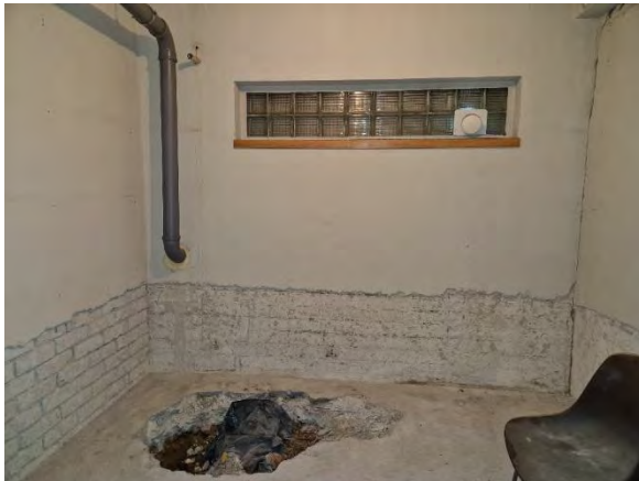
Kuva 15 Sakaristosiiven kellarikerroksen maanvastaisten seinien alaosista on poistettu maali- ja rappauspinnat rakenteissa esiintyvän poikkeavan kosteuden takia.
