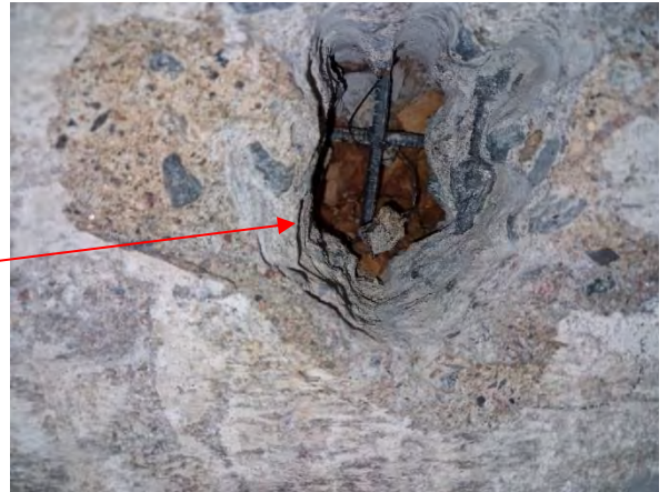
Kuva 22 Maanvastaisen seinän eristemateriaalit ovat kosteusvaurioituneet. Ulkopinnassa olevan betonirakenteen sisäpinnassa ei todettu bitumisivelyä.
