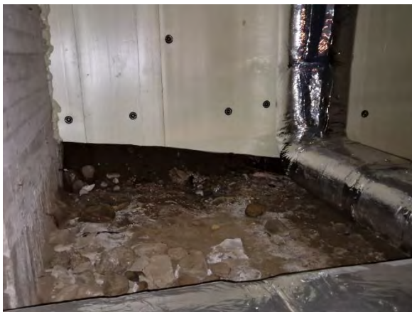
Kuva 19 Ryömintätilaan pääsee kulkeutumaan rakennuksen ulkopuolista kosteutta maanvastaisten seinärakenteiden alitse.
