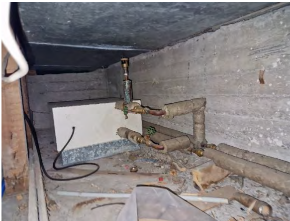
Kuva 82 Korokelattian alla on rakennusjätteitä ja pinnoittamattomia mineraalivillaeristeitä.
