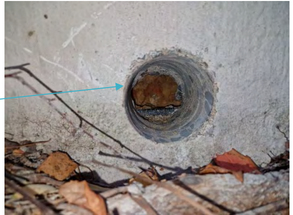
Kuva 69 Ulkoseinän alaosaan esiintyy ulkopuo- lisen kosteusrasituksen aiheuttamia vaurioita ja aistinvaraisten arvioiden pe- rusteella lämmöneristeet ovat kosteus- vaurioituneet.
