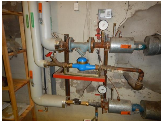
Kuva 39 Yleiskuva vesimittarista ja pääsuluista
