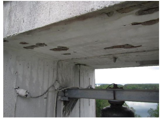
Kuva 8 Kellotornissa esiintyy mm. korroosiovaurioita
