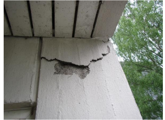
Kuva 20 Teräskorroosion aiheuttama betonivaurio ulkoseinärakenteessa
