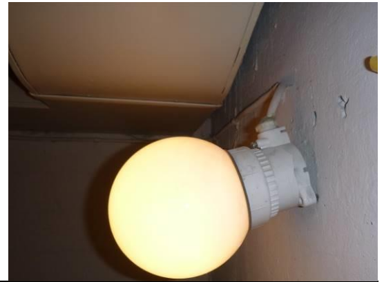
Kuva 56 Yleiskuva irronneesta valaisimesta.
