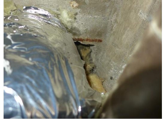
Kuva 10 Ryömintätilasta lähtevät läpiviennit ovat epätiivitä
