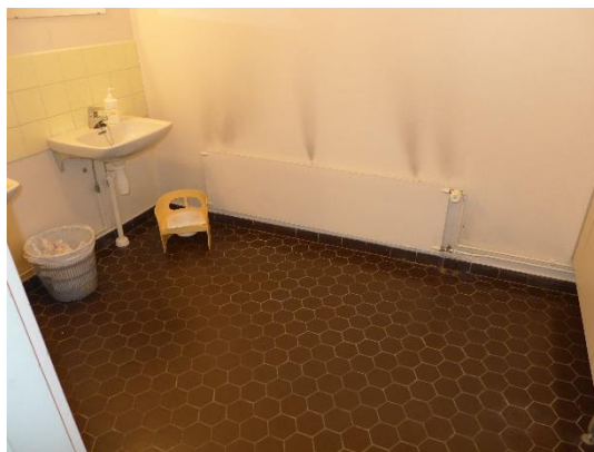
Kuva 31 WC-tilat ovat käyttöikänsä lopussa
