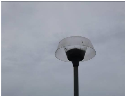
Kuva 57 Alkuperäiset ulkovalaisimet ovat huonossa kunnossa.
