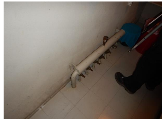
Kuva 38 Yleiskuva lattialämmityksen jakotukeista.
