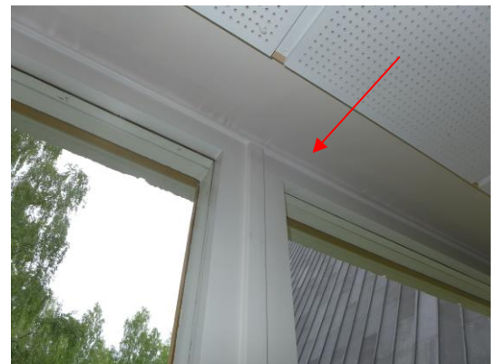
Kuva 12 Rippikoulusalissa havaittiin ilmavuotojälkiä
