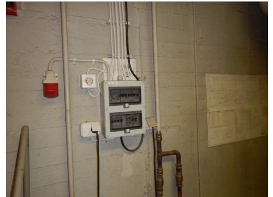
Kuva 40 Yleiskuva perusvesipumppaamon keskukselta.
