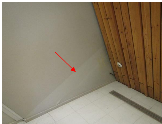
Kuva 13 Lehterillä olevissa pilarirakenteissa havaittiin halkeamia
