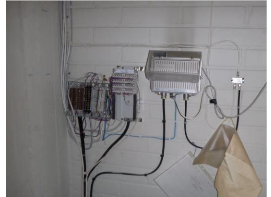
Kuva 60 Yleiskuva puhelinjakamosta ja antennivahvistimesta.
