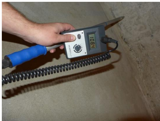
Kuva 11 Kellarikerrokseessa esiintyy kohonneita pintakosteusarvoja
