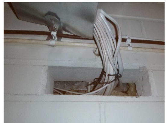
Kuva 52 Yleiskuva puuttuvasta palokatkosta.
