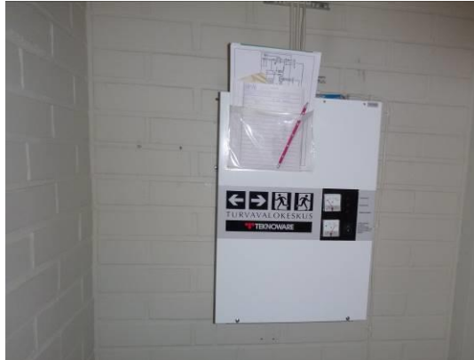
Kuva 59 Puhelinjakamohuoneeseen asennettu turvavalaistuskeskus.
