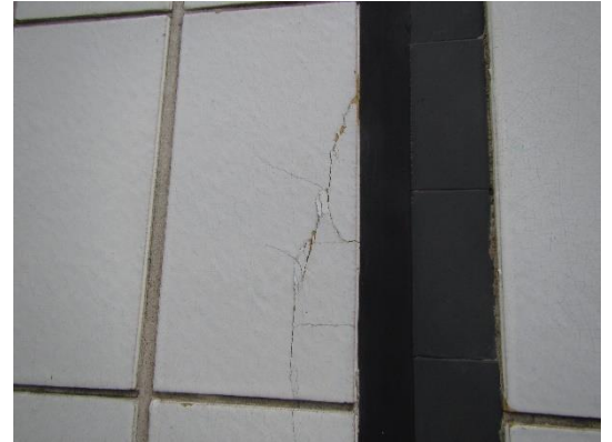
Kuva 16 Klinkkelementtien pinnoilla on yksittäisiä halkeamia
