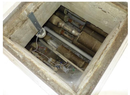
Kuva 14 Rippikoulusalin lävitse kulkee putkikanaali
