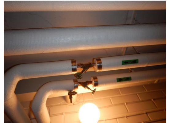
Kuva 36 Yleiskuva lämpöjohtoverkoston venttiileistä.
