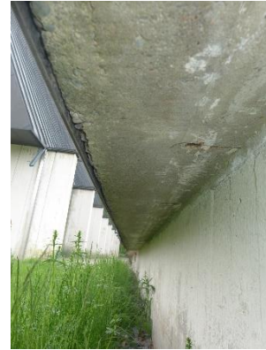
Kuva 6 Tukimuureissa esiintyy mm. kosteuden aiheuttamia vaurioita
