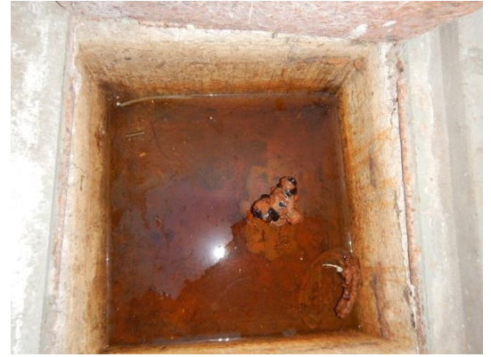
Kuva 44 Padotusventtiilikaivossa on vettä ja venttiili on pahoin syöpynyt.
