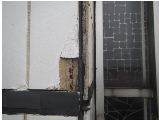
Kuva 17 Elementtien reunaosissa on paikoin kiinnityksestään irronneita klinkkereitä
