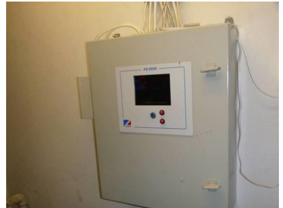
Kuva 62 Yleiskuva rakennusautomaatiojärjestelmän alakeskuksesta.
