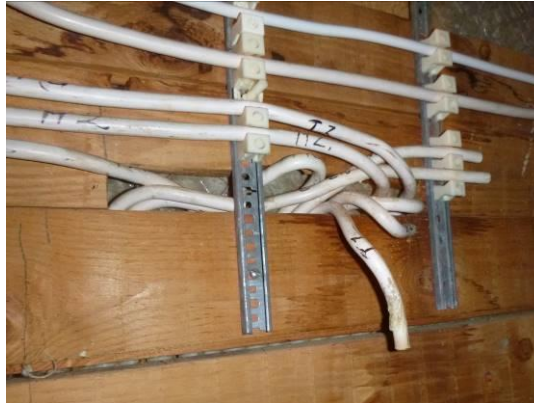
Kuva 53 Kellarikerroksen iv-konehuoneessa on avoimia kaapeleita.
