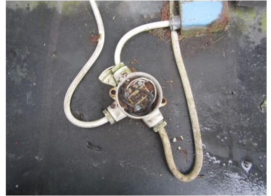
Kuva 54 Alttari-ikkunan takana on avonainen jakorasia.
