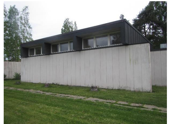
Kuva 18 Betoniseinien pintakäsittely on kulunut
