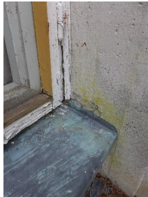
Kuva 23 Julkisivu- ja ikkuna liittymät ovat epätiivitä
