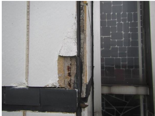
Kuva 5 Ulkonurkan paikkaus on irronnut ja ulkokulman teräksessä on korroosiovauriota.
