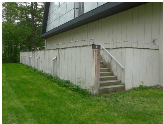
Kuva 26 Punaleväää tukimuurin pinnalla.
