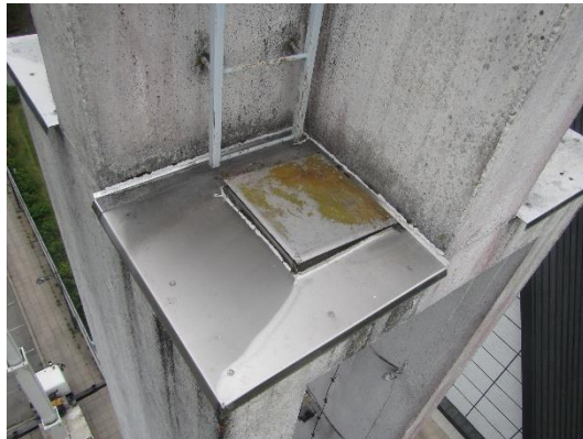
Kuva 17 Pellitysten kittauksissa epätiiviyttä. Pellitysten päällä kasvaa sammalta.
