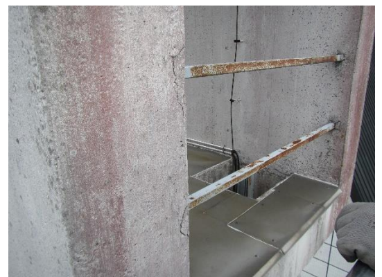
Kuva 16 Kaiteiden liittymissä havaittiin halkeilua.
