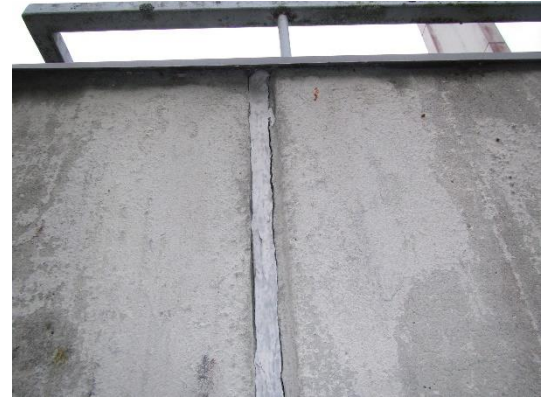
Kuva 25 Tukimuurin saumauksessa on halkeilua ja epätiiviyttä.
