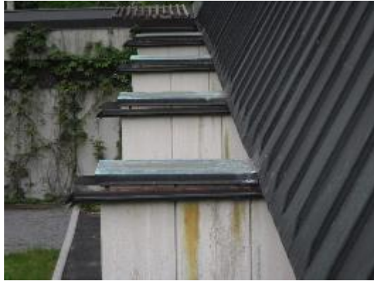
Kuva 31 Pilastereiden pellityksiä, valumajälkia.
