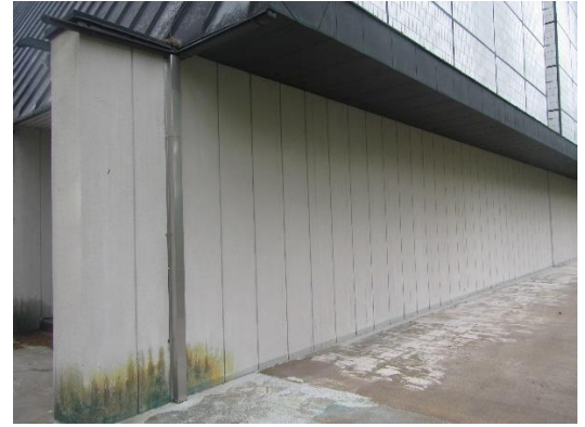
Kuva 14 Pohjoispuolen julkisivua. Kuparivärjäytymiä julkisivulla, vesikatolta valuva vesi roiskuu julkisivulle.
