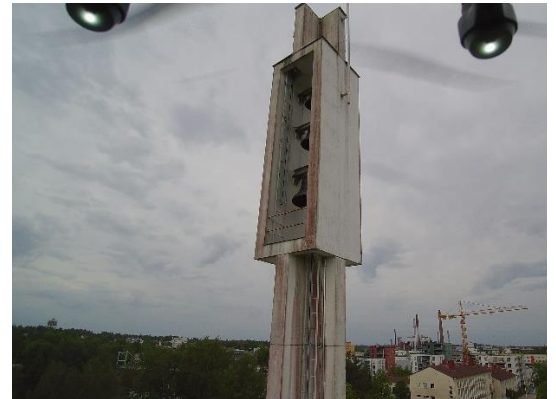
Kuva 18 Betonipinnoilla valumajälkiä ja punaleväkasvustoa.
