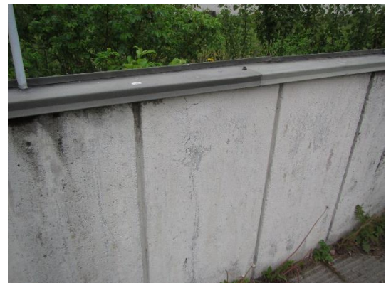
Kuva 20 Tukimuurissa pystysuuntainen halkeama.
