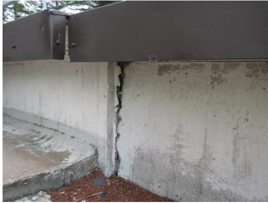
Kuva 24 Tukimuri kallistunut yläreunastaan ja muurien välinen sauma on haljennut.
