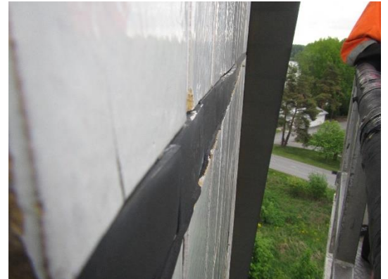
Kuva 8 Klinkkerilaatat irronneet alustastaan.
