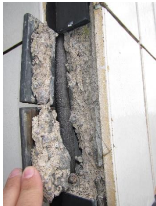
Kuva 7 Ikkunasyvennyksen ulkokulman pakkasrapautumista.
