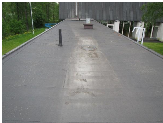
Kuva 30 Katteella jälkiä veden lammikoitumisesta
