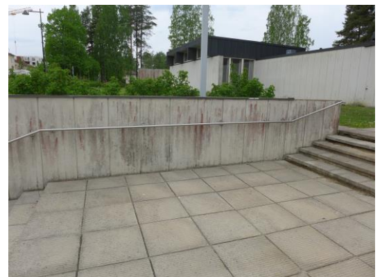
Kuva 27 Muurin pinnoitteet kuluneet, yksittäinen pellitys puuttuu
