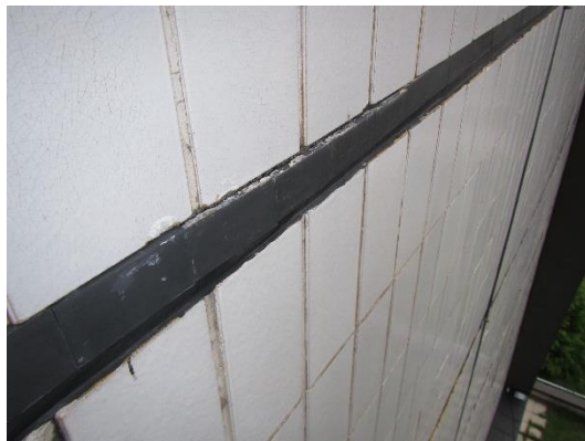
Kuva 11 Kiinnityksestä irti olevia klinkkereitä.
