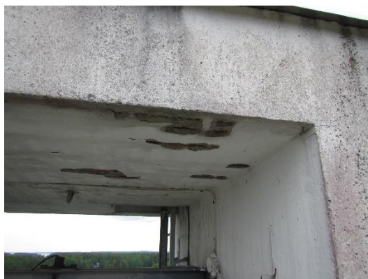
Kuva 15 Laattarakenteen alapinnan teräskorroosiovaurioita. Korroosio on irrottanut rakenteesta betonikappaleita.
