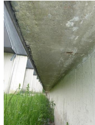
Kuva 22 Lipparakenteen alapinnan vaurioita.
