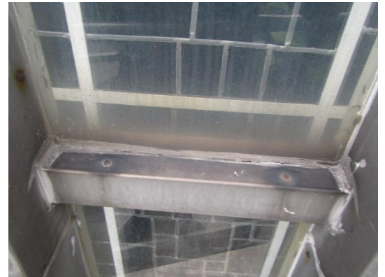
Kuva 40 Lasien kittauksissa halkeilua ja epätiiviyyttä.
