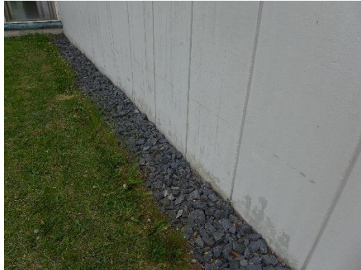
Kuva 13 Seinän alareunan maalipinta hilseilee.
